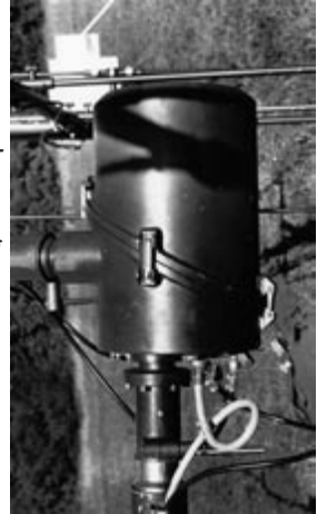
Bild 5: Antennendrehsystem zur Veränderung von Azimut und Polarisation. Die Antennenverstärker sind im Innern der Gehäuse.
