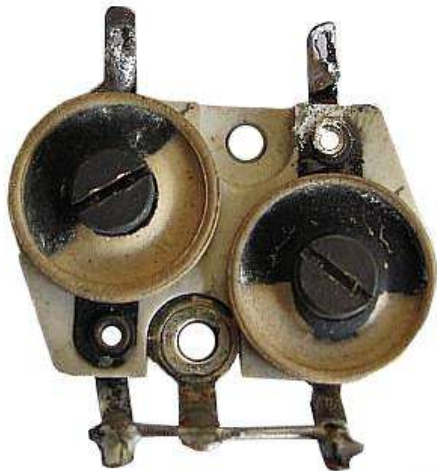
Die defekten Bauteile
