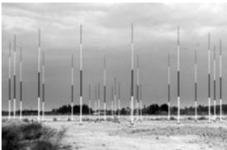
Bild 17: Stationäres Adcock-Antennensystem 0,3-30 MHz mit außen 16, innen acht Antennen. (Werkfoto Plath)
