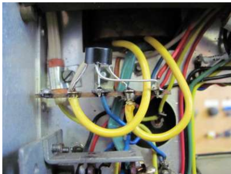
Brückengleichrichter ersetzt Selengleichrichter
