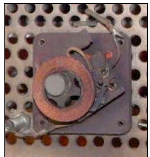
Der an der Rückwand montierte Sperrkreis
