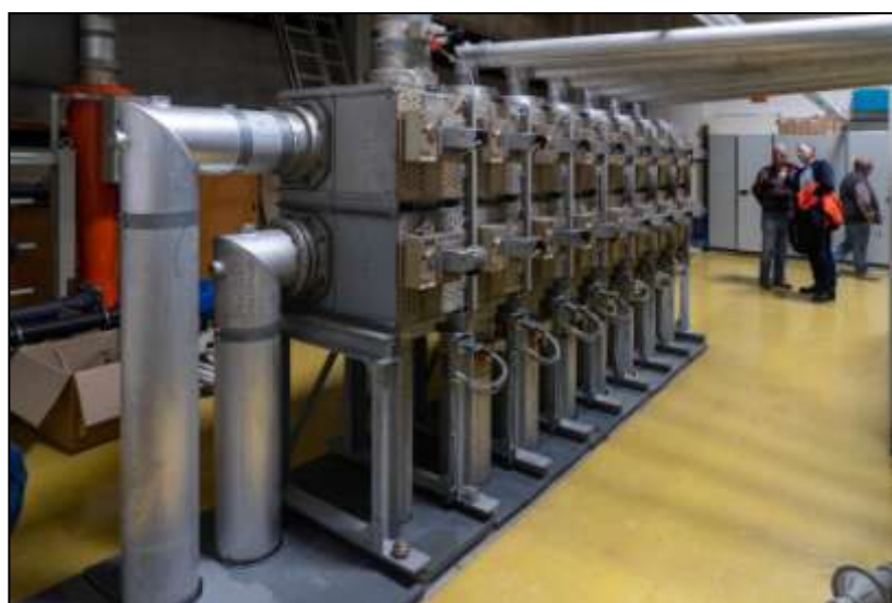
Ansicht des des Antennenschalters
