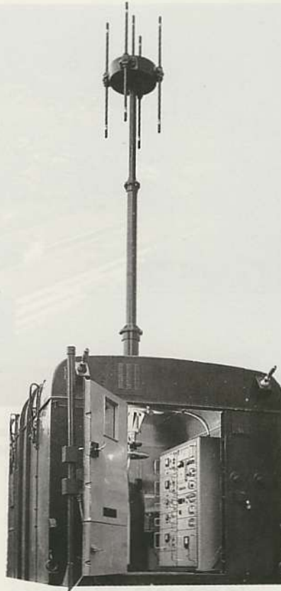
VHF-Sichtpeilanlage für den Flughafen München
