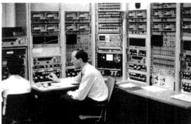
Bild 6: FmAufklGerSatz UHF III in der grenznahen Aufklärungsstelle „Hoher Meißner“. Links oberhalb der Tischplatte die Empfänger RS-111, darüber ein Antennensteuergerät für die Kreisgruppe, in der Mitte das Kanalschaltfeld, Spektrumanalysator SD 330 und Bandaufzeichnungsgerät, rechts und links je ein TF-Demodulator TFD-1000 mit Kanalbelegungsanzeige, oben diverse Kassettenbandgeräte C 3/20.
