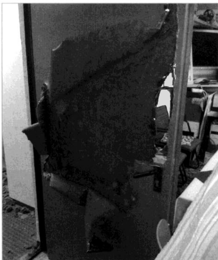
Bild 1: Die „bearbeitete“ Eingangstür.
