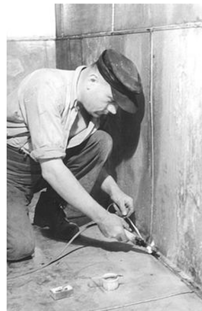
Bild 2: Blechauskleidung des Gleichrichterraumes.
