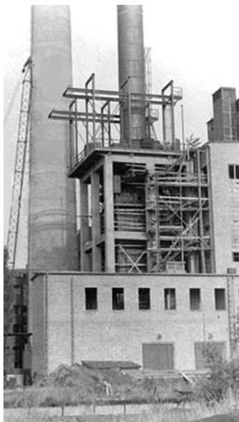
Bild 1: Staubabscheider zwischen Kessel und Schornstein.
