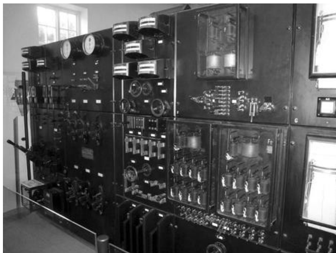
Bild 9b: Ein Teil der Schalttafel für den Sender. Bild: U. Gumpert
