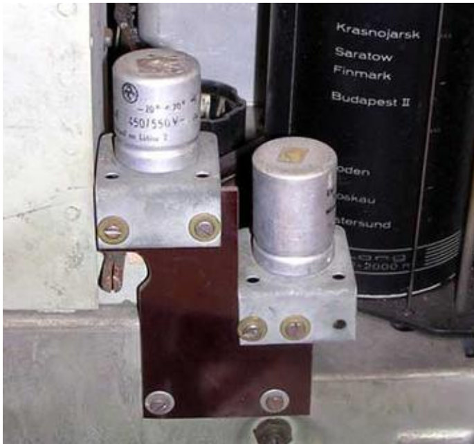
Bild 11. Die bei einer früheren Reparatur eingebauten Netzteil-Elkos.
