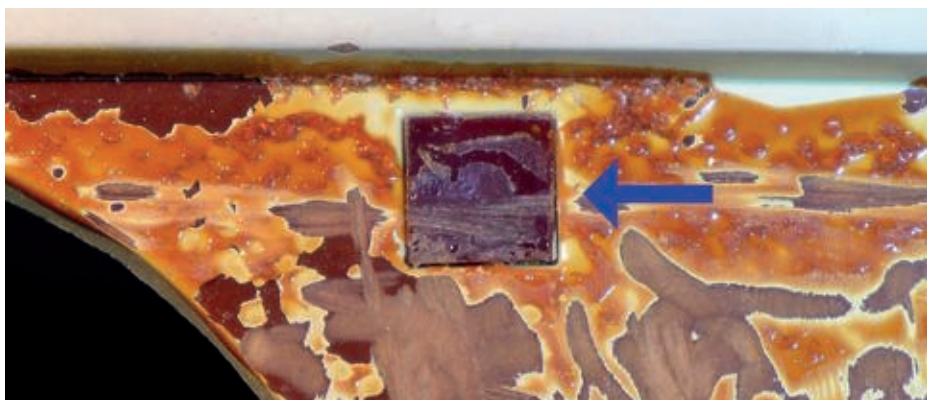
Bild 3. Die Vierkantschrauben zum Lochblech hin sind mit quadratischen Pertinax-Plättchen als Berührungsschutz isoliert.
