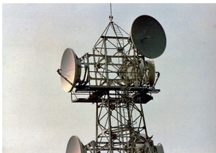
Bild 9. Richtfunkantennen auf einem gesonderten Gitterturm. [12]
