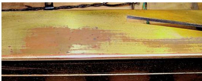
Bild 6: Ungleichmäßig entfernte Korrosionsschicht
